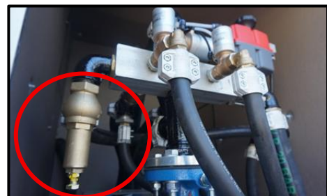
Imagen 25. Detalle Válvula de Seguridad
