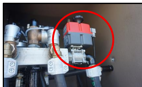
Imagen 26. Válvula reguladora de presión
