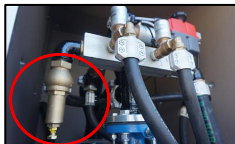
Imagen 25. Detalle Válvula de Seguridad
