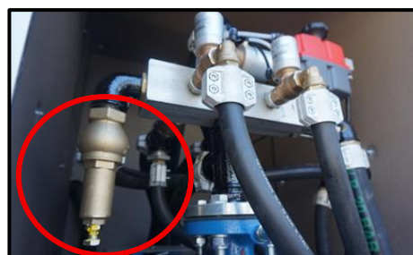
Imagen 25. Detalle Válvula de Seguridad
