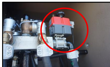
Imagen 26. Válvula reguladora de presión
