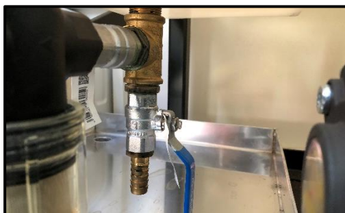
Imagen 13: Detalle válvula vaciado
