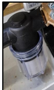
Imagen 11: Detalle filtro admisión bomba
